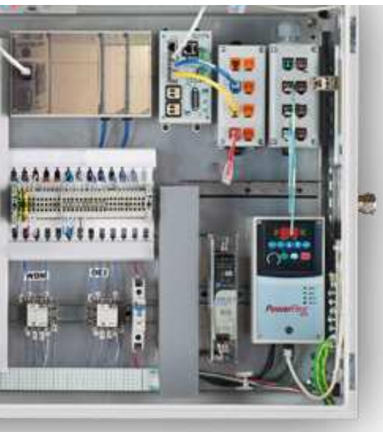
tủ điện, thiết bị điện electrical equipment
